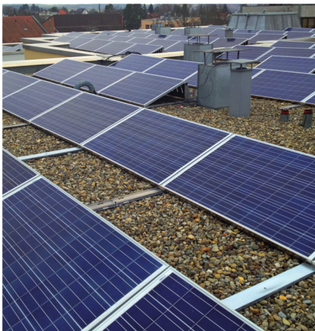
Neue PV-Anlage in Oberasbach.
