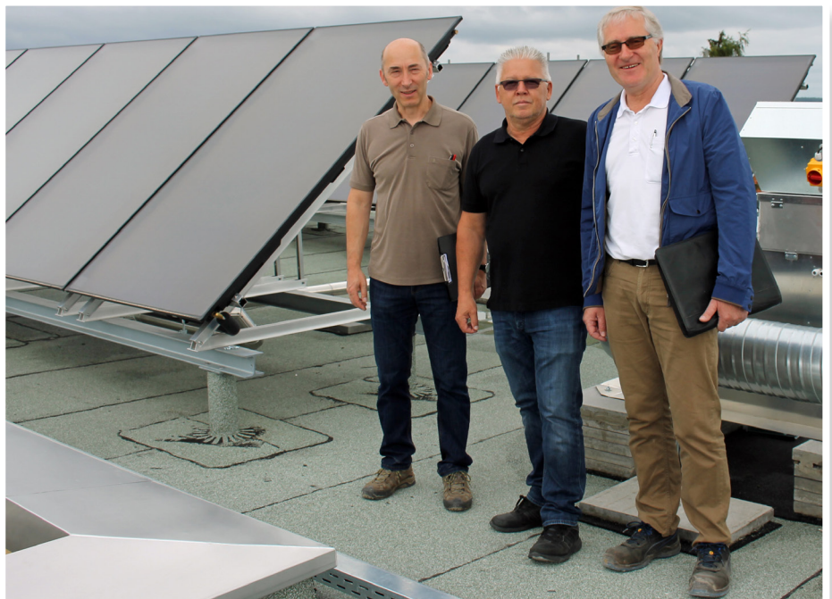
Die Fachplaner Michael Sattler, Karl-Heinz Bonk und Udo List auf dem Hausdach der Aster-/Lilienstraße in Unterասbach vor den Solar- und Photovoltaikanlagen.
