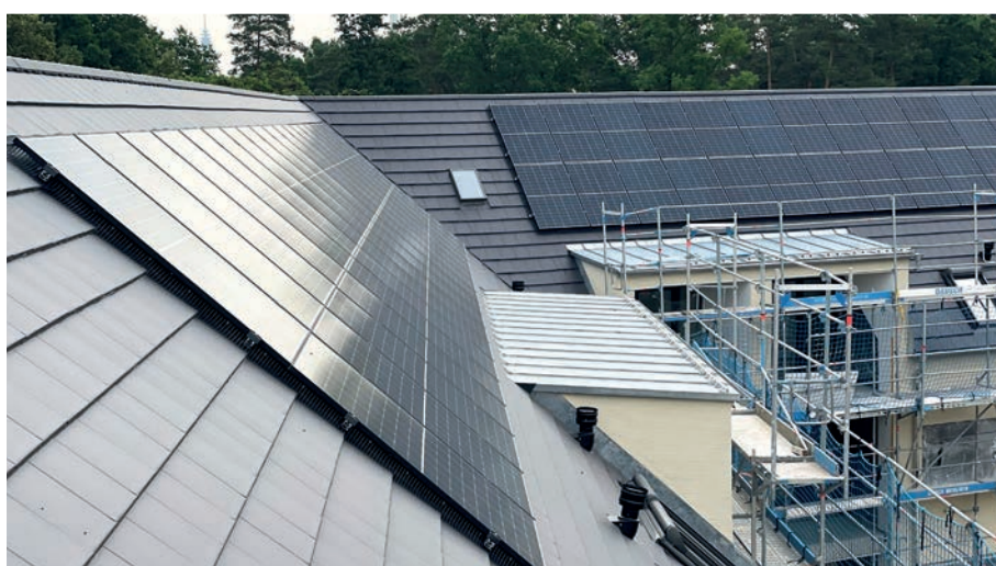
Die neue PV-Anlage Astenstraße 6, 6 a, 6 b spart jährlich bis zu neun Tonnen CO 2 ein.
