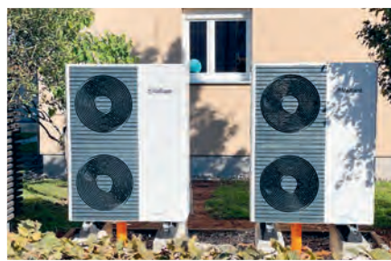
Luftwärmepumpen am Lilienplatz 9 in Oberasbach.
