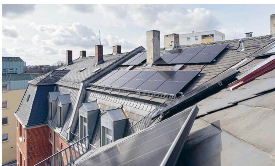
Neue PV-Anlage auf dem Dach der Erlanger Straße 36 in Fürth.
