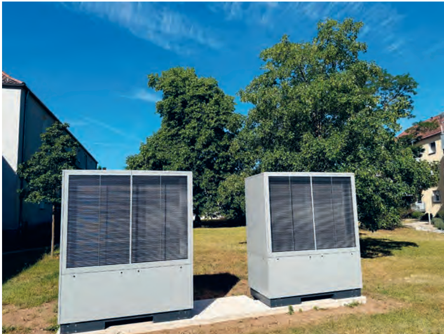
Luftwärmepumpen in der Tulpenstraße.
